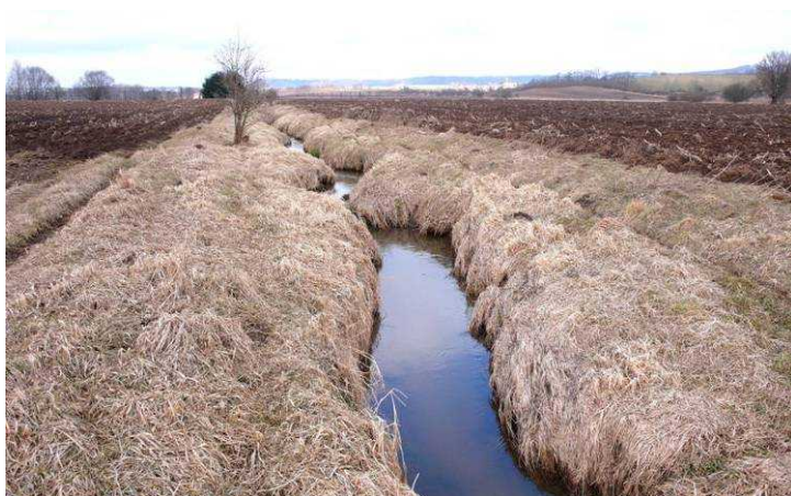
Obr. 34 Potok v polích byl upraven napřímením a vybudováním geometricky pravidelné kynety, opevněné laťovými plůtky. Koryto však celkově není příliš hluboké, laťové plůtky se rozpadají. Kyneta se samovolně zvlňuje a pro tento vývoj je k dispozici jakýsi prostor v travnatém potočném pásu. I tento úsek potoka lze zařadit do skupiny B.
