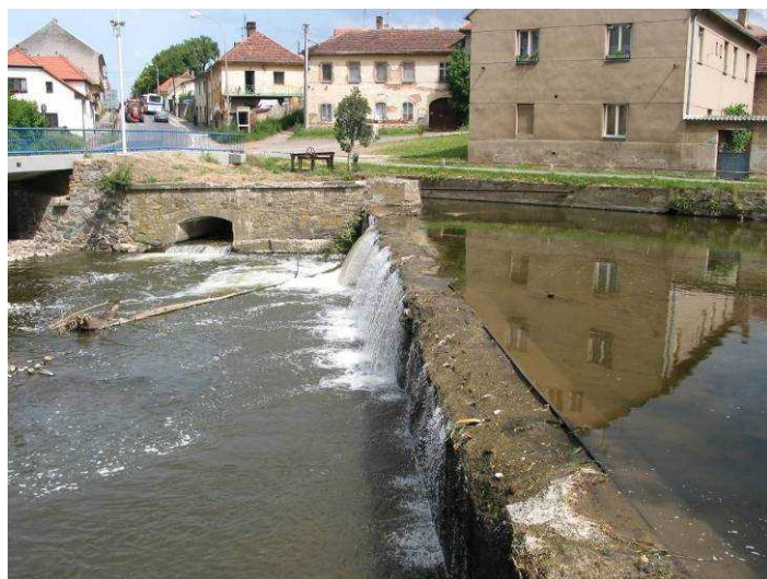
Obr. 12 Jez vytváří migrační překážku pro vodní živočichy. Také degraduje vodní tok tím, že jej zbavuje přirozených tvarů podélného profilu a omezuje jeho hydraulickou členitost. V některých situacích mohou jezy posilovat povodňové ohrožení zástavby.
