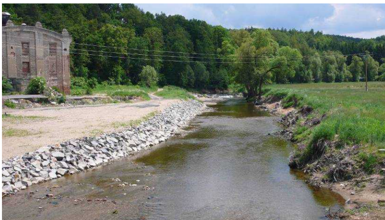
Obr. 36 Přijatelná opatření po povodni: Břeh koryta, na který navazuje zástavba, byl stabilizován kamennou rovinaninou. Břehu, za nímž následuje louka, byly ponechány členité tvary, vytvořené povodní.
