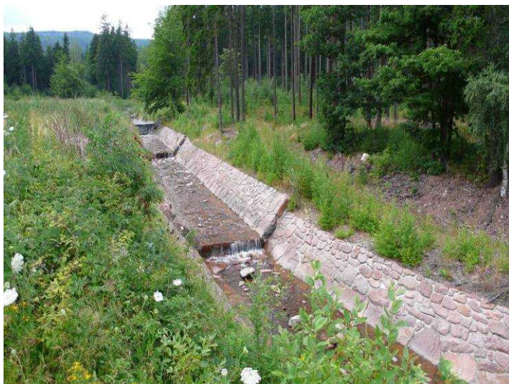
Obr. 19 Dlažďený korzet není přiměřeným způsobem úpravy lesního potoka. I pro povodňově exponované úseky s velkými sklony existují řešení vhodnější, méně devastující, lépe spolupracující s tvárným zeminovým podložím a levnější. Niveletu dna lze stabilizovat například balvanitými skluzy.
