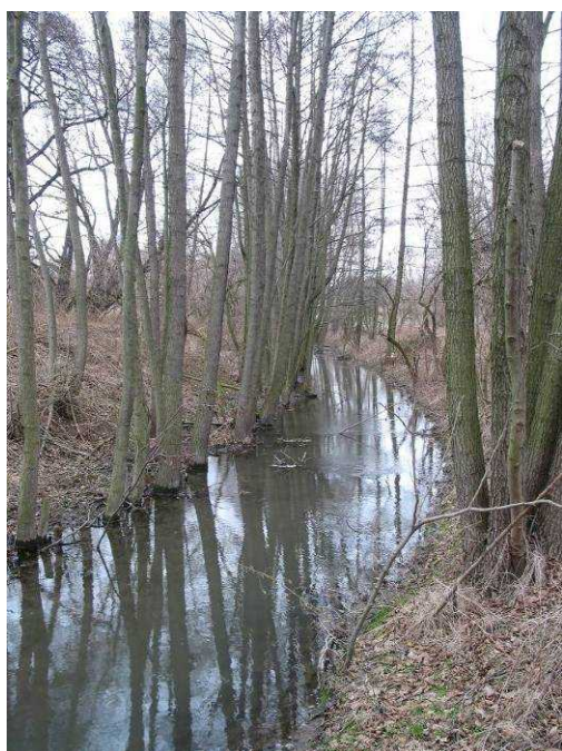
Obr. 28 Starší technická úprava koryta zarůstá v břehových čarách stromy, dno se díky malému podélnému sklonu zanáší. Pokud byla kyneta technicky opevněná, pak toto opevnění je již skryto pod usazeninami. Zřejmě bude efektivnější ponechat tento úsek dalšímu samovolnému vývoji, podporovanému drobnějšími, převážně neinvestičními opatřeními, než provádět nákladnou revitalizaci.
