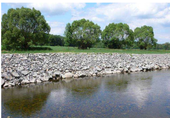
Obr.38 Bylo nutné nátržemi modifikovaný břeh, navazující na louky, opravovat nákladnou, geometricky pravidelnou kamennou rovinou? Nebylo možné ponechat břeh v povodňovém stavu nebo jej stabilizovat alespoň přírodě bližším a levnějším způsobem, například méně pravidelným kamenným záhozem?
